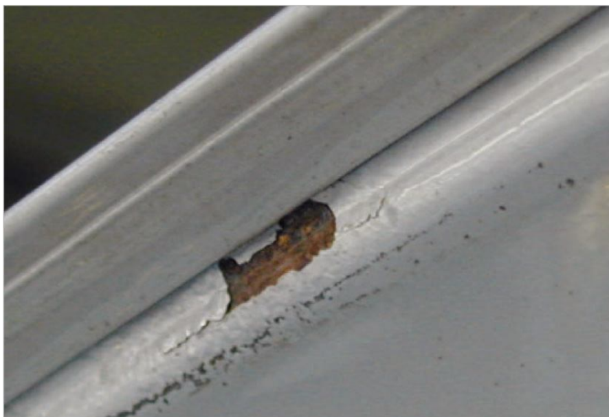
Рис. 2.18 Коррозия на отбортовке
